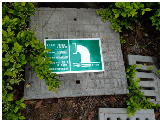
图4-4 污水接管口及标识牌
