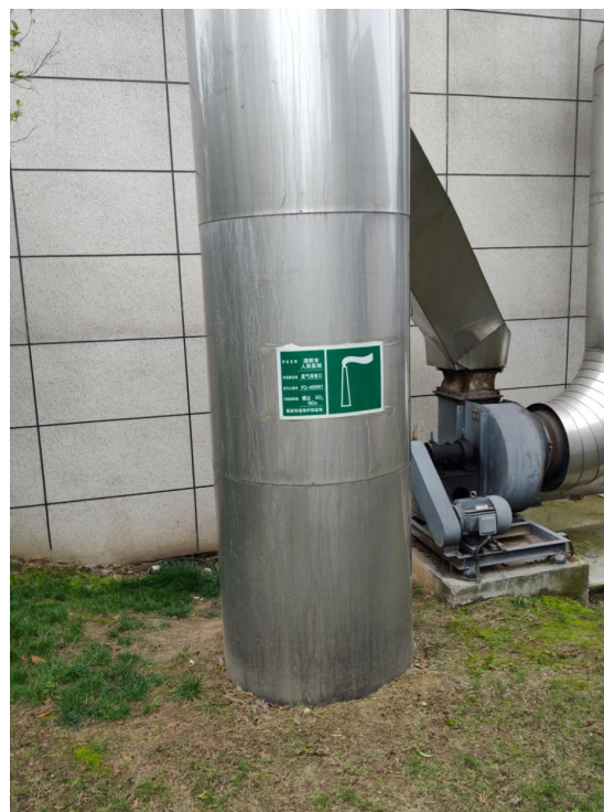
图4-9 锅炉废气排气筒标识
