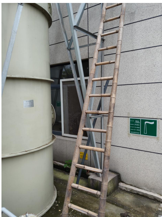
图4-8 等离子废气除臭塔标识
